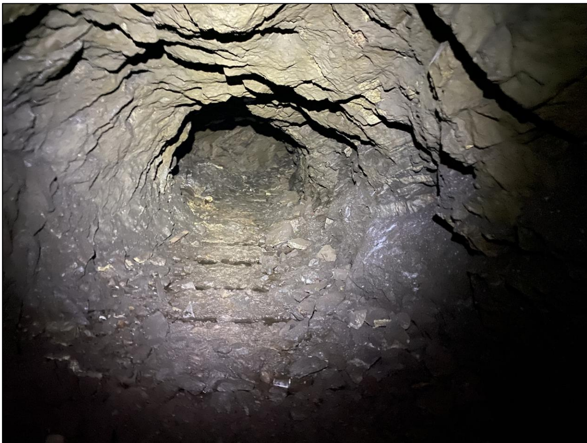
Figur 3-17. Oppsprukket berg i mindre tunnel drevet parallelt med hovedtunnel.
