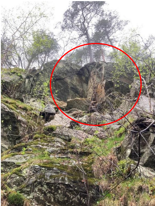
Foto 5: Sår etter ferskt nedfall.
