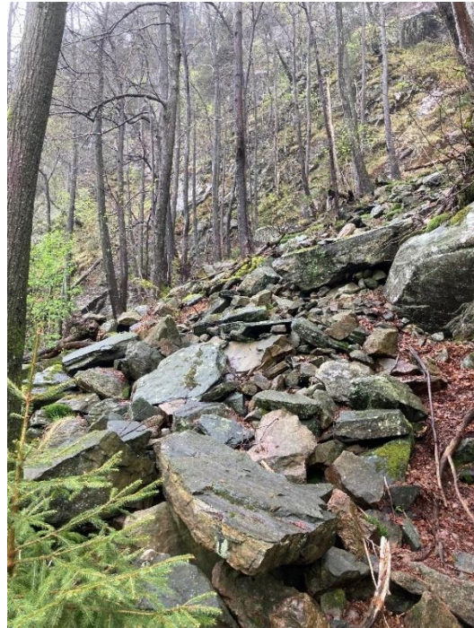
Foto 4: Avsetninger etter steinsprang. Foto mot sørvest.
